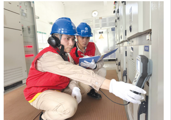
5月30日,国网建瓯市供电公司组织党员服务队在建瓯一中高考考点配电室进行设备巡检检测。
