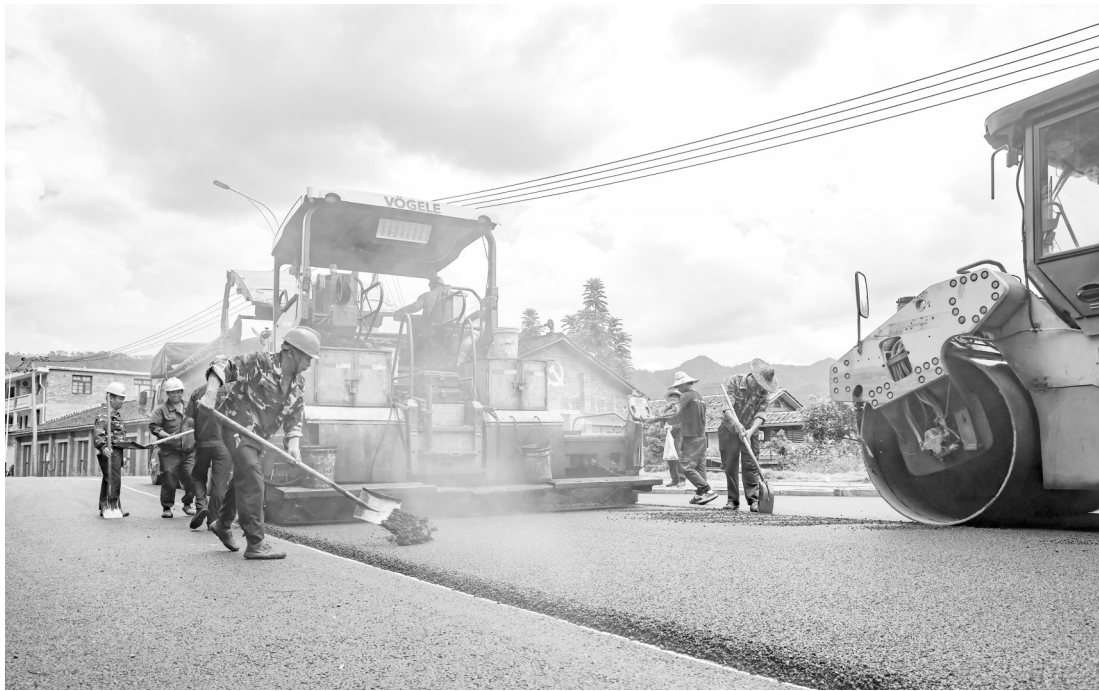
5日,在顺昌县埔上镇万全社区排水管网修复及改造工程现场,工人抓紧施工。项目完工后,将解决道路积水问题,并同步实现“白改黑”、照明升级等。近年来,埔上镇通过精细化治理、系统性改造,持续提升镇容村貌,陆续完成了22幢建筑立面改造,打造了3处景观节点,新建了停车场、全民健身中心、农贸市场等,让集镇功能更加完善,百姓生活更加幸福。(朱宇 廖敏恺 郭家顺 摄)
