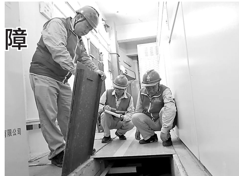
国网邵武供电公司组织人员对低洼易涝区域配电室开展巡视检查
