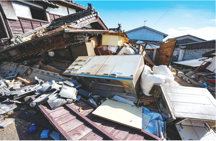
这是7月30日在日本熊本县拍摄的受损房屋。日本熊本县灾害对策总部7月30日下午通报说，熊本县7.1级地震造成的死亡人数已上升至34人。（新华社记者 贾造成 摄）
