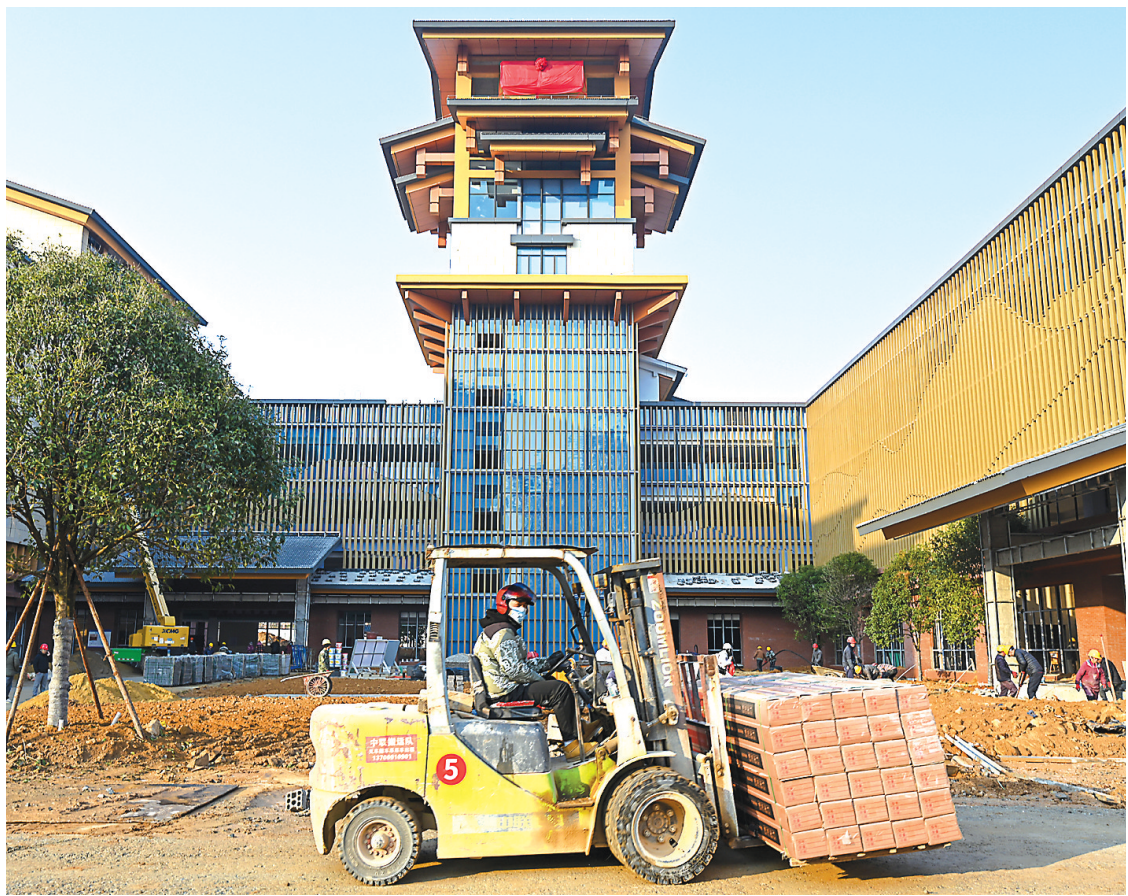
15日,位于武夷新区的南平市老年教育文体活动中心项目施工现场,工程车辆往来穿梭,工人加紧施工。该项目总投资约2.67亿元,建筑总面积约3.4万平方米,目前已进入收尾阶段。项目建成投用后将进一步满足老年人教育、文体活动等需求。(张行健 摄)
